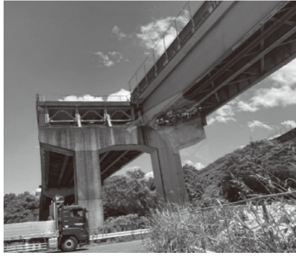
九州自動車道 八代市上方町 道路が寸断。
