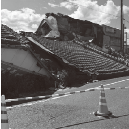
宇城市内の倒壊した家屋。 耐震のない日本家屋が多く被災
