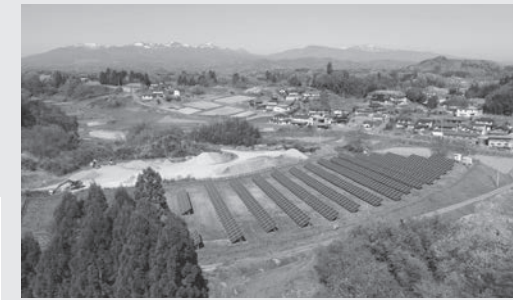
二本松発電所
