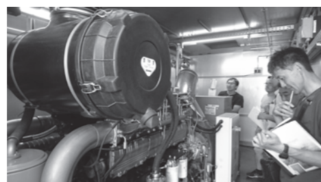
少し大きめのガス発電機。どこにいても発電プラントの状況がわかるようにセンサーが設置されている
